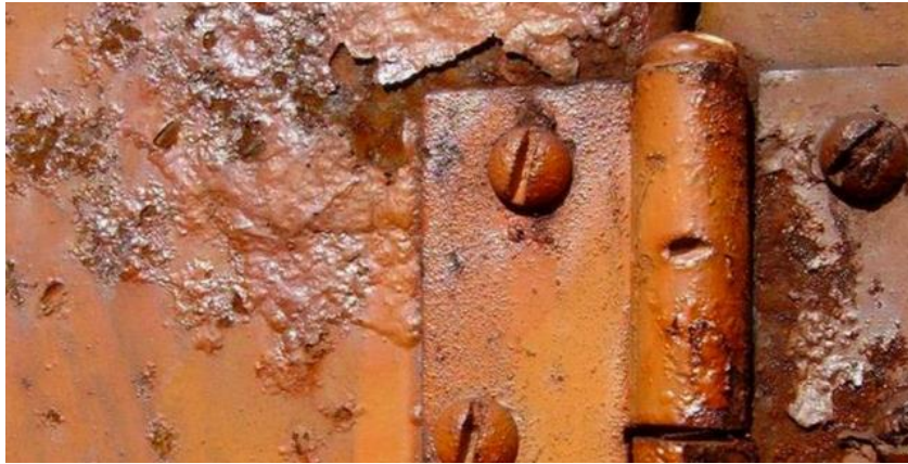
Şekil 1.5. Yüksek sıcaklık korozyonu
