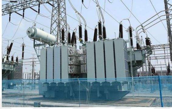
Resim 2.16. Şalt sahasında yer alan bir güç transformatörü
