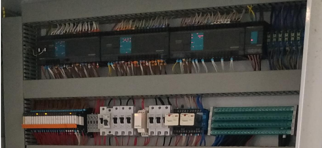
Şekil 2.22. Örnek PLC panosu
