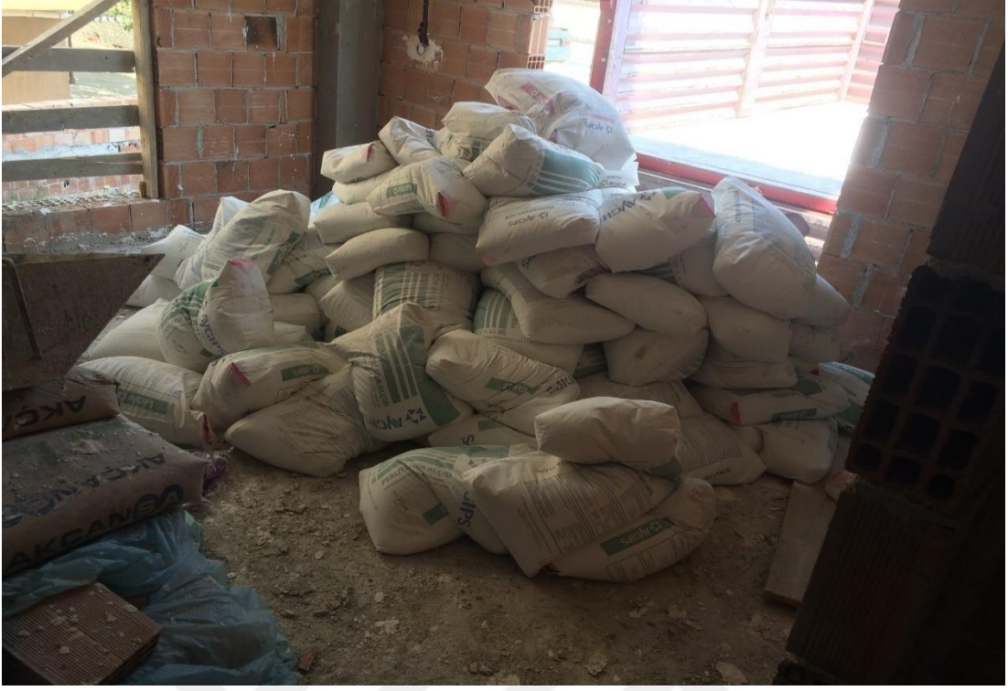
Resim 4.2. İnşaat içerisinde malzemelerin istiflenmesi (yanlış uygulama)
