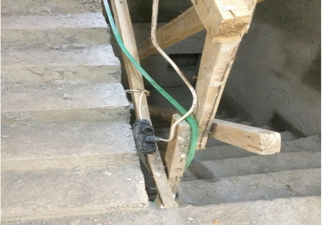
Resim 4.13. İnşaat içi elektrikli cihazlar (yanlış uygulama)
