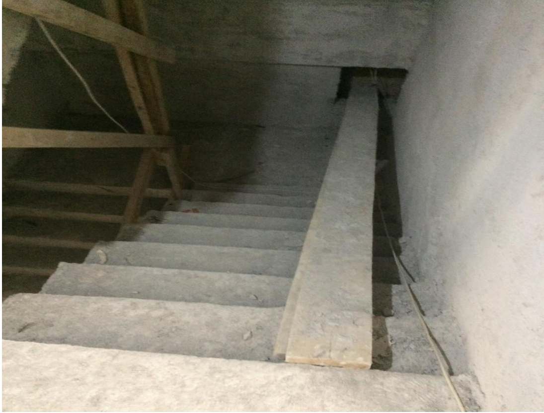
Resim 4.11. Zemin ve geçiř yolları (yanlıř uygulama)
