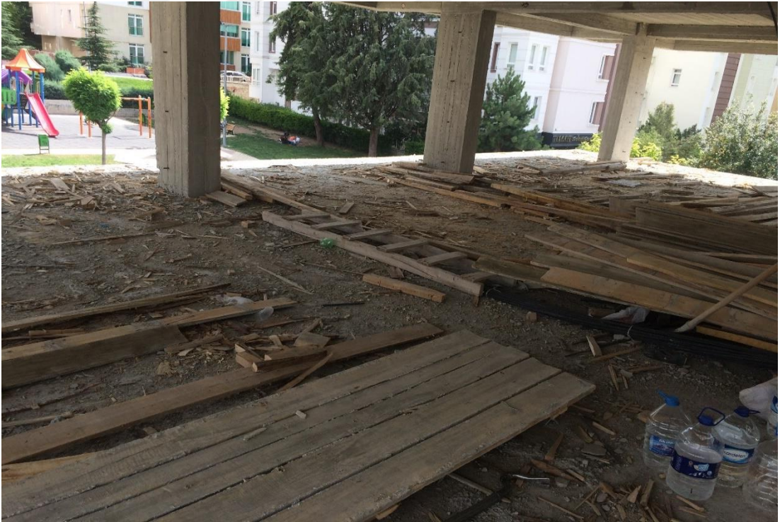
Resim 4.3. İnşaat kat zeminleri (yanlış uygulama)
