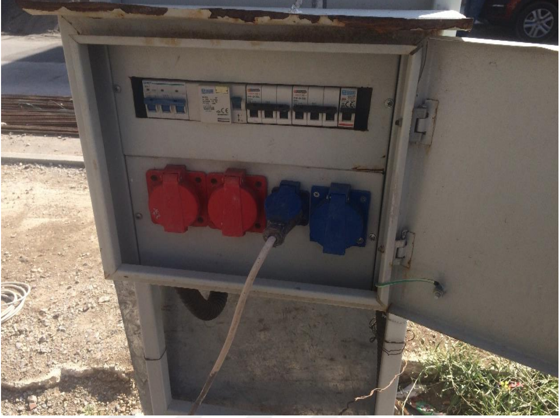
Resim 4.12. Şantiye elektrik panosu (doğru uygulama)
