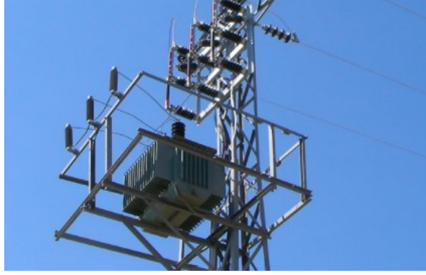
Resim 1.3. Direk tipi trafo
