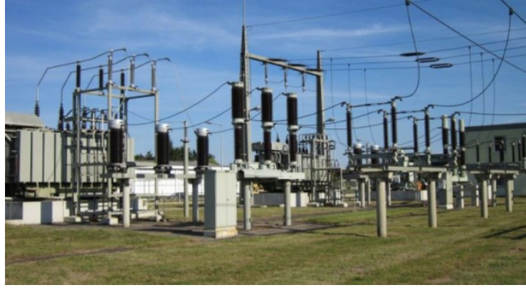
Resim 1.5. Açık şalt sahası
