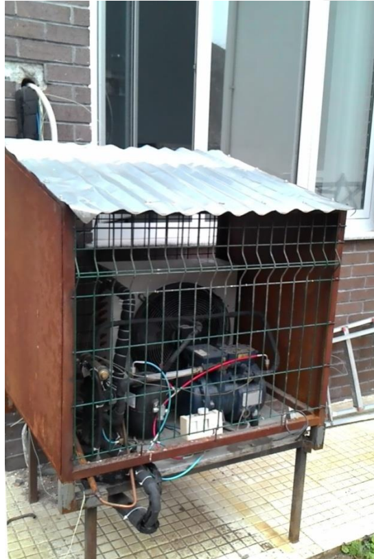
Resim 4.2. Soğutma sistemi dış ünitesi
